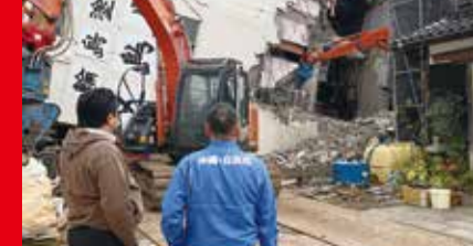
珠洲市で被災地の現場を視察し、復旧の課題を確認
