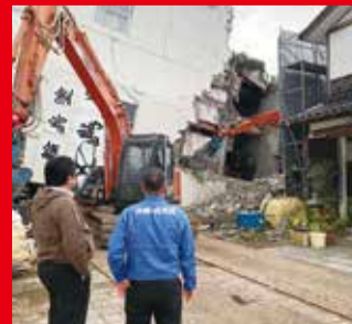
珠洲市で被災地の現場を視察し、復旧の課題を確認
